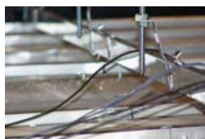
No.3 天井破壊：クリップ外れ
