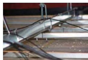
No.3 天井破壊：野縁からボード脱落
