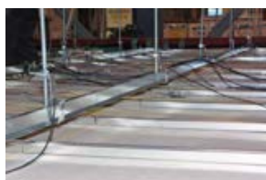
No.3 天井破壊：クリップ外れ
